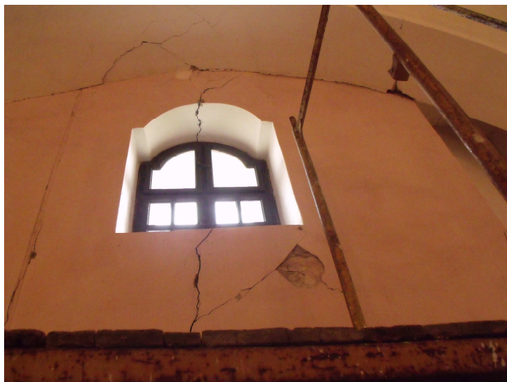
34. ábra A nyugati homlokzat falrepedései
