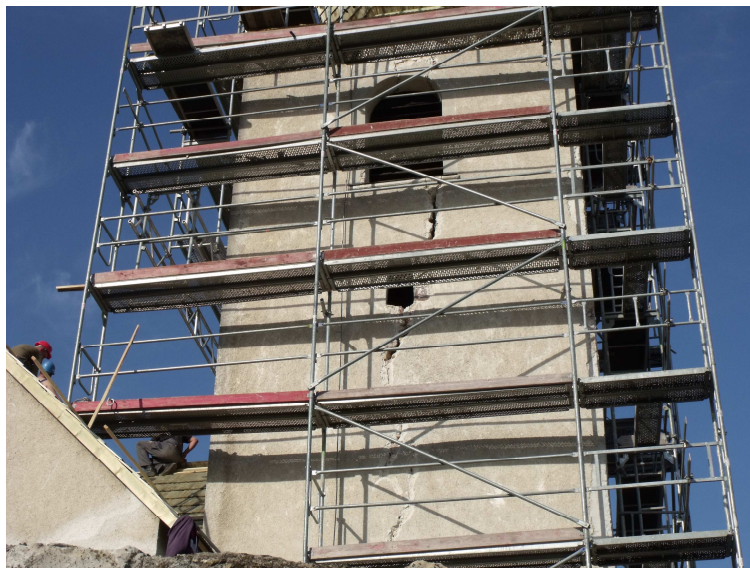
36. ábra A torony nyugati oldalán a vakolat alól előkerült repedések
