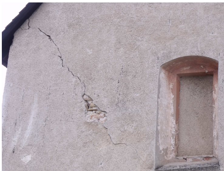
35. ábra A nyugati homlokzat falrepedései
